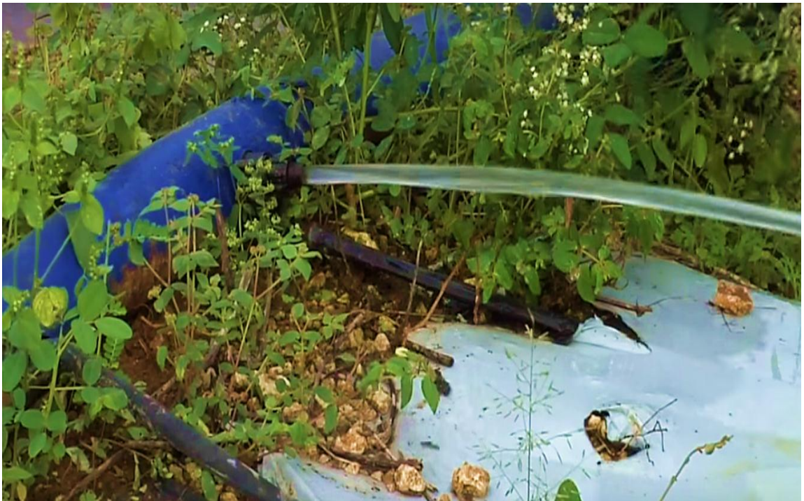
Рисунок 1.19 – Разрыв соединения между капельной линией и коллектором (манифолд) из-за повышения давления, что приводит к переувлажнению (заболачиванию) области в начале капельной линии и недостаточному подаче воды в конце линии.
