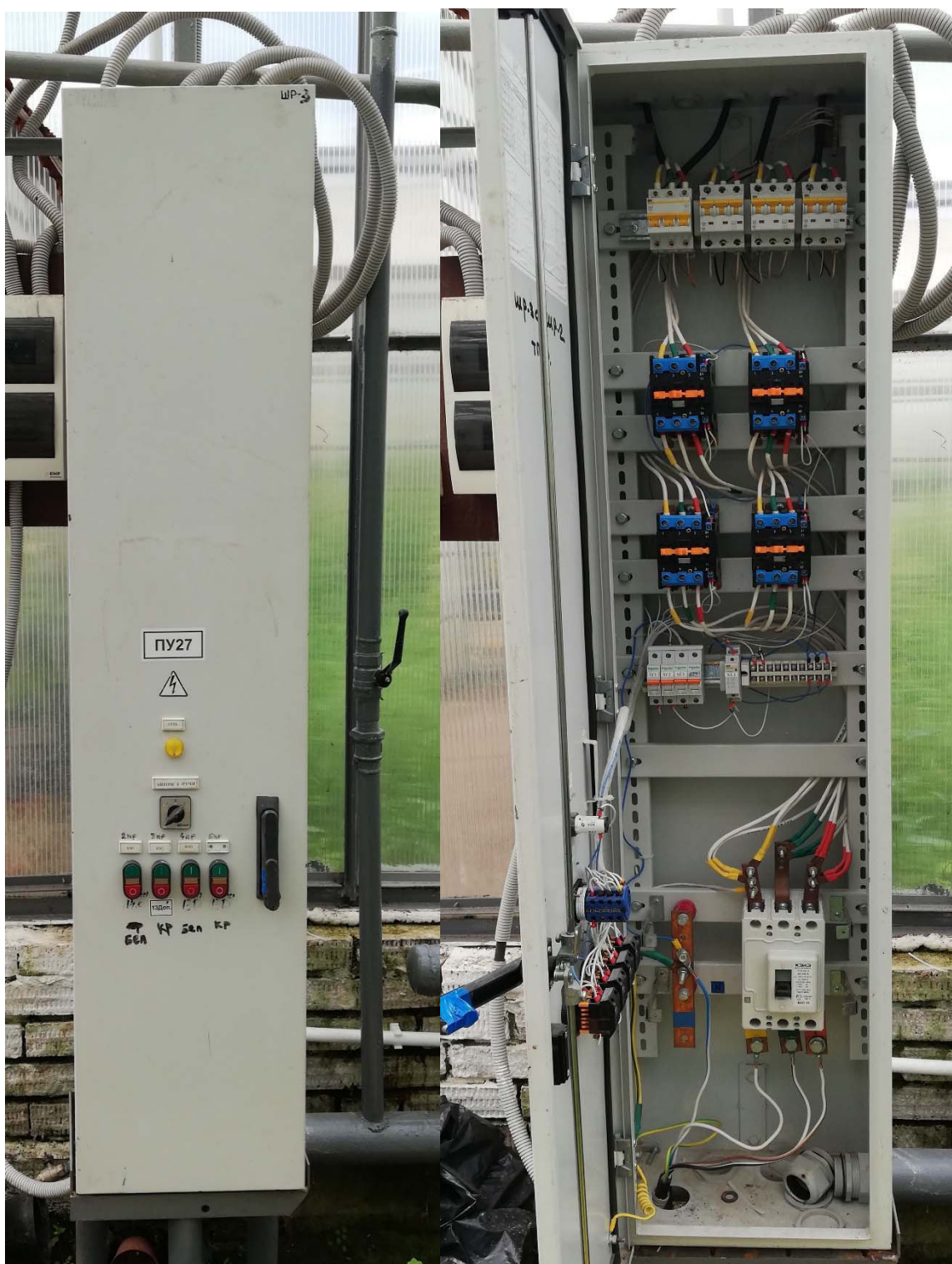
Рисунок 21 - Шкаф управления системы освещения теплицы №2.
