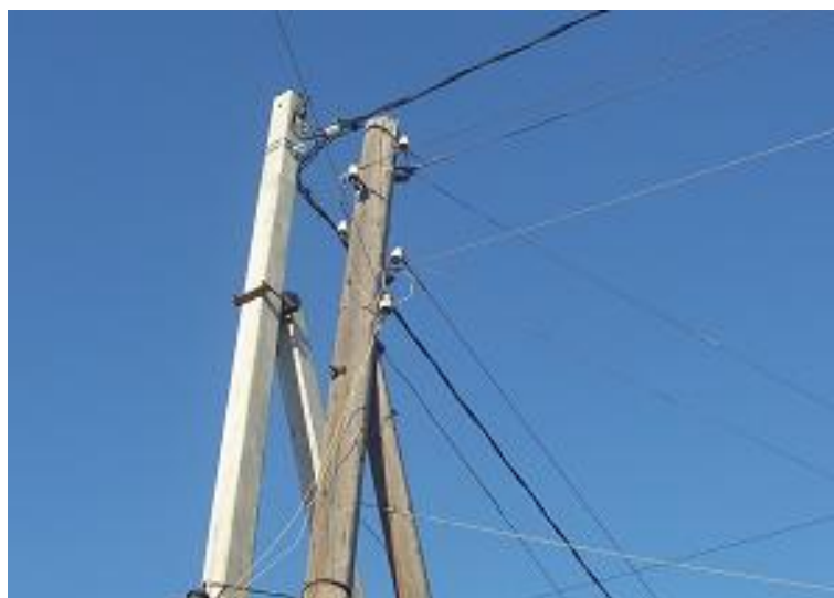
Рисунок 8 — Пример воздушной линии 0,4кВ
