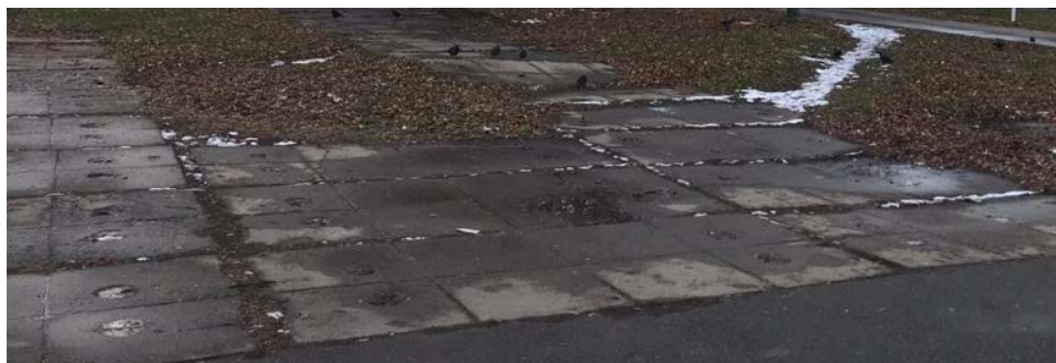
Рис.11. Состояние плитки при входе в сквер
