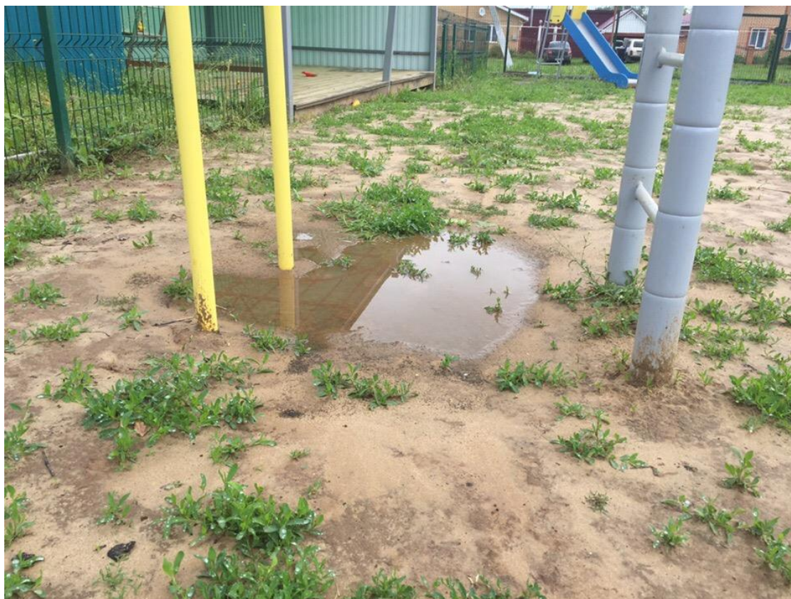
Рис.3. Нарушение отвода воды с территории
