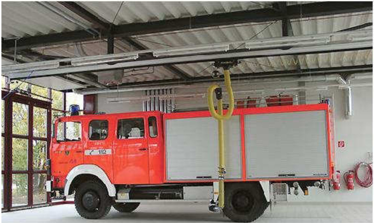
Рисунок 3.2 – Автоматическая система вытяжки выхлопных газов.
