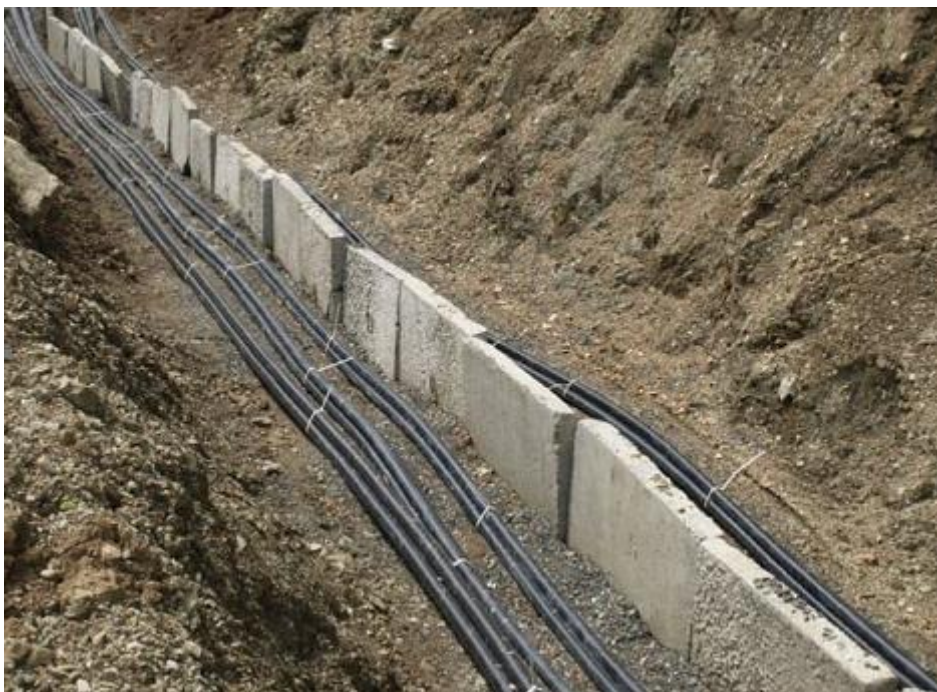
Рис. 13. Кабельные линии электропередачи (подземные)
