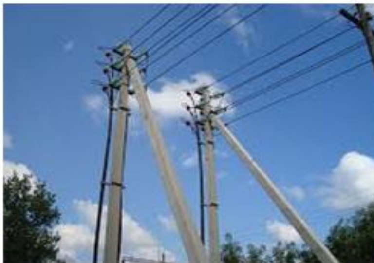
Рис. 12. Воздушные линии электропередачи
